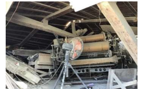
いぐさ製織作業場の倒壊
