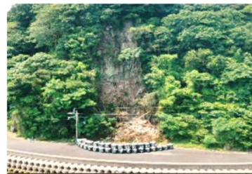
山腹崩壊による土砂流出
