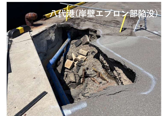
港湾施設の被害状況
