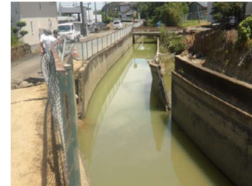
農業用水路の被害 （水路壁の損壊）
