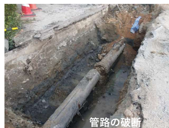
水道の被害状況
