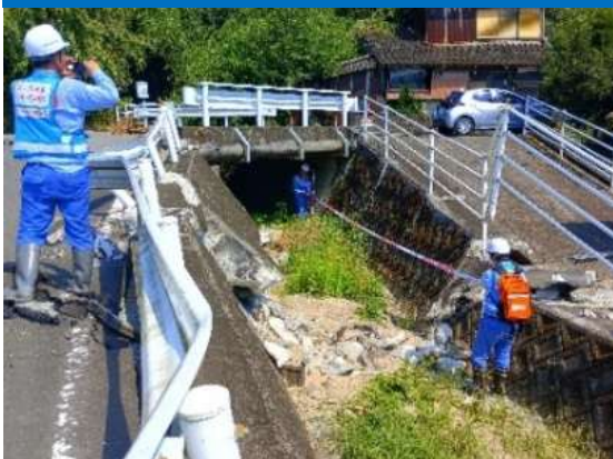
■被災状況調査
