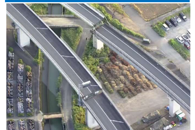
■防災ヘリによる被災状況調査
