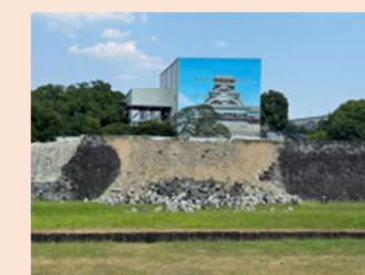
石垣の崩落等 （熊本市熊本城）
