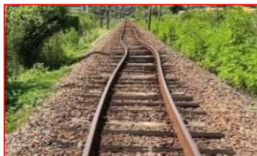
肥後高田～日奈久温泉間 軌道変状
