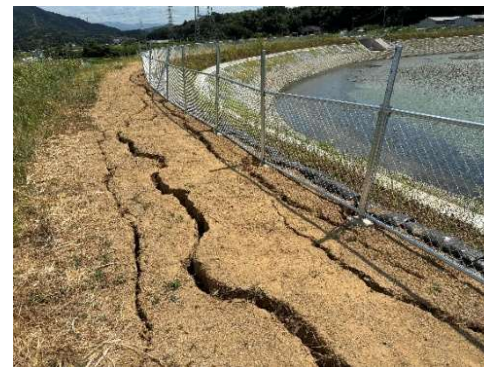
ため池の被害 （堤体上部の亀裂）
