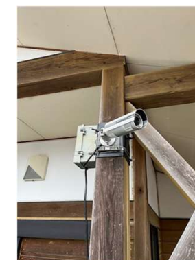
防犯カメラの設置
