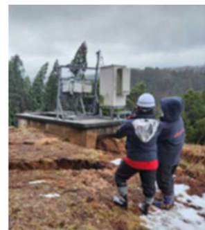
基地局の損壊
