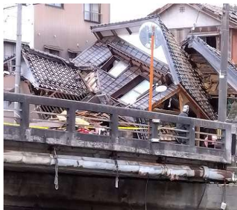
石川県穴水町 民家の被害
