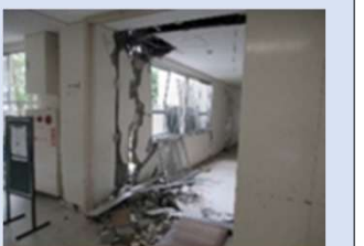
学校施設の被害
