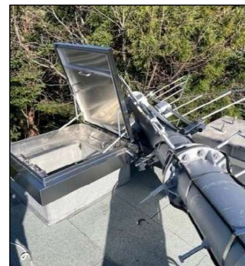
送信アンテナの損壊
