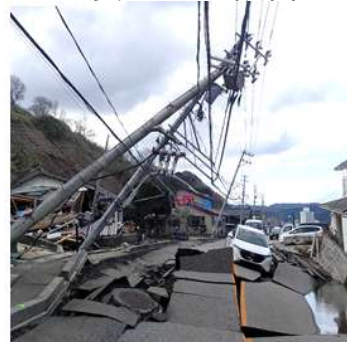
地震による被害
