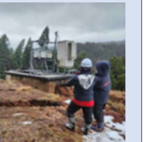
通信基地局の損壊
