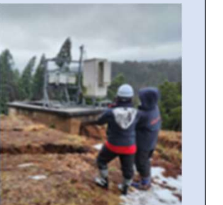
通信基地局の損壊
