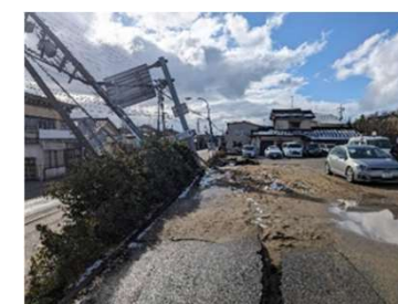
液状化被害(内灘市街地)
