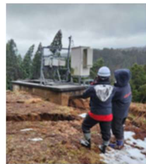
基地局の損壊
