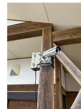
防犯カメラの設置
