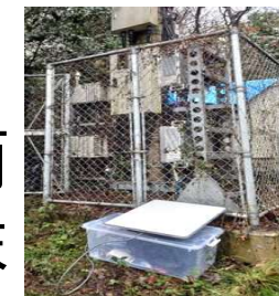
可搬型衛星アンテナ
