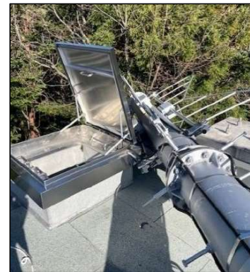
送信アンテナの損壊
