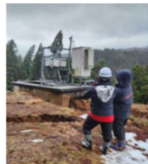
基地局の損壊
