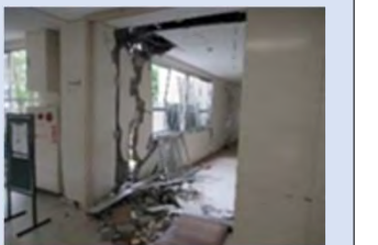
学校施設の被害
