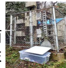
可搬型衛星アンテナ
