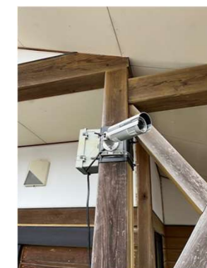
防犯カメラの設置
