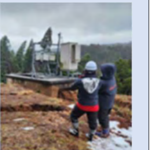
通信基地局の損壊
