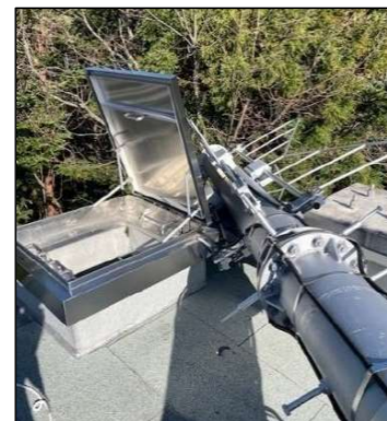
送信アンテナの損壊
