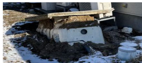
地震により浮き上がった浄化槽(画像は七尾市内の例)
