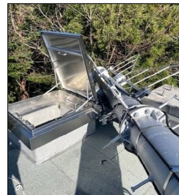
送信アンテナの損壊
