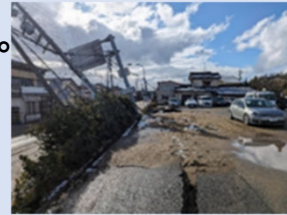
液状化被害(内灘市街地)
