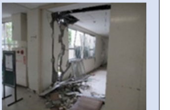
学校施設の被害
