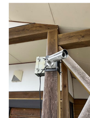
防犯カメラの設置
