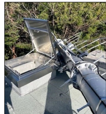
送信アンテナの損壊
