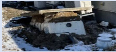
地震により浮き上がった浄化槽 (七尾市内の例)
