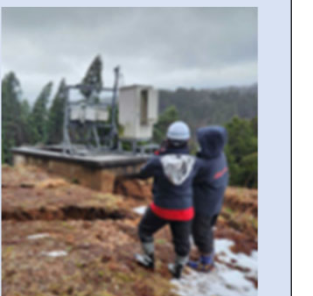
通信基地局の損壊
