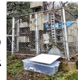
可搬型衛星アンテナ
