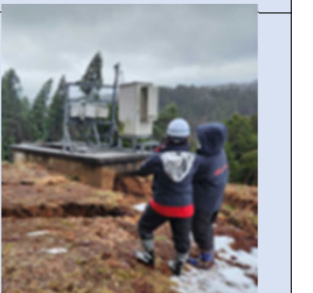
通信基地局の損壊
