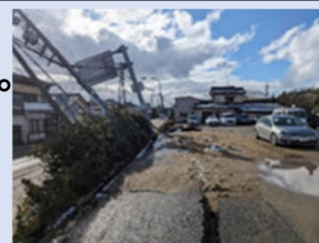
液状化被害 (内灘市街地)
