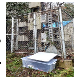
可搬型衛星アンテナ
