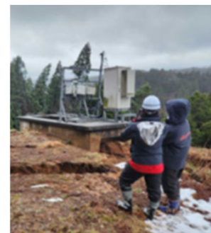
基地局の損壊
