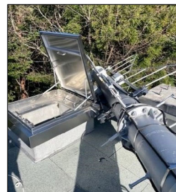
送信アンテナの損壊
