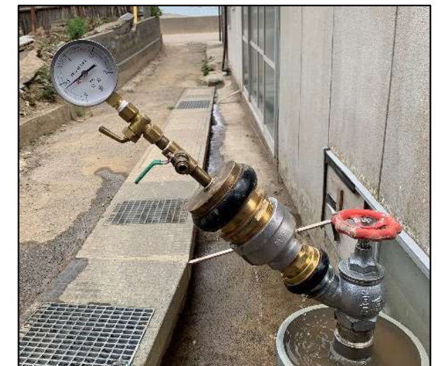
管内圧力計測
