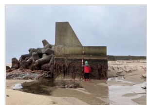
鹿磯漁港（輪島市）の地盤隆起
