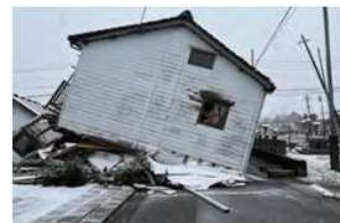
木造住宅の倒壊被害
