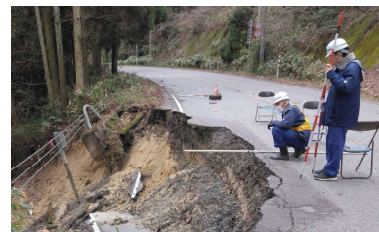
危険箇所での被災状況調査
