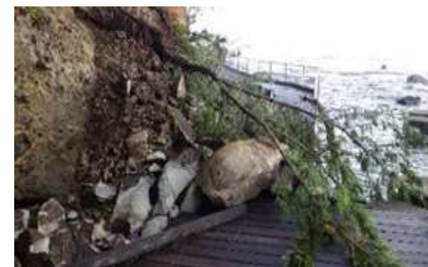
九十九湾園地（能登町） 土砂崩れにより歩道が損壊
