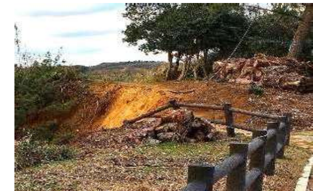
巖門園地（志賀町） 法面や柵が崩落
