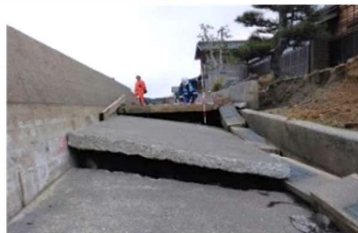
護岸・水叩き損傷
