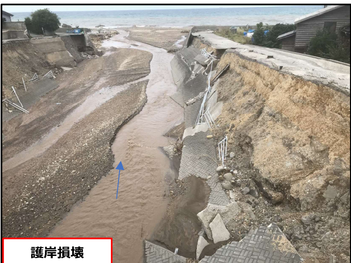
写真④ 珠洲大谷川
