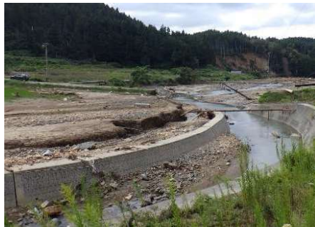
河川の氾濫による農地の被害
