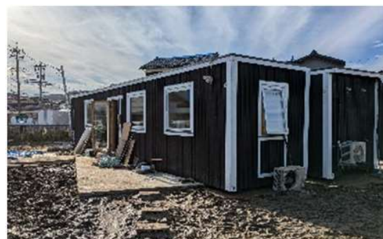
仮設工房の土台が浮いて流されている
