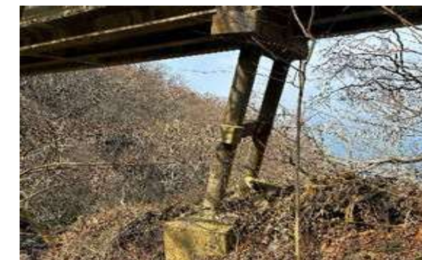
歩道（輪島市） 橋脚が損壊
