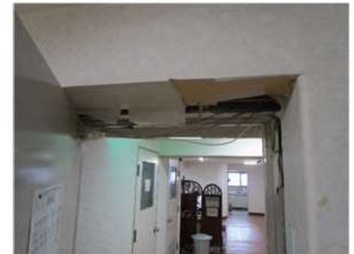
【地震により落下した 医療施設病棟の天井パネル】
