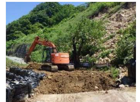
崩落土砂撤去（農地地すべり）（輪島市）
