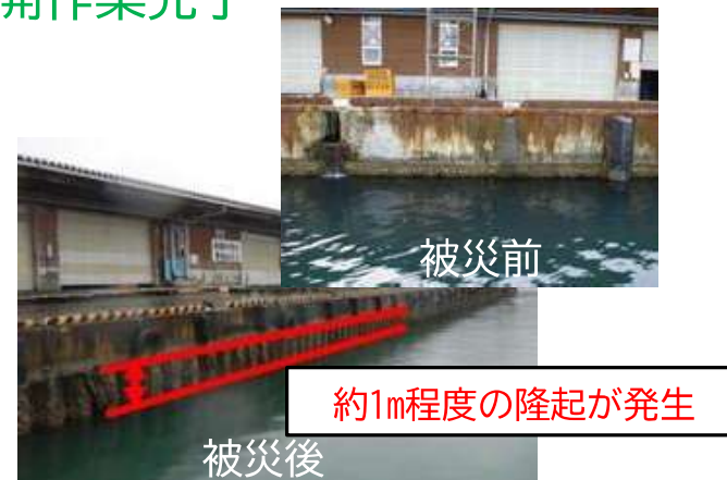
船だまりの被害状況
