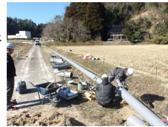
珠洲市 熊谷汚水中継ポンプ場から珠洲市浄化センターまでの仮設圧送管の布設 (2/17)
