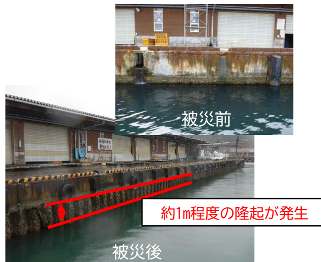
船だまりの被害状況
