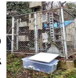
可搬型衛星アンテナ
