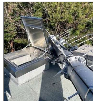
送信アンテナの損壊
