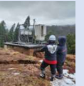
通信基地局の損壊
