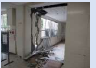
学校施設の被害
