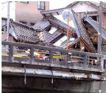
石川県穴水町 民家の被害
