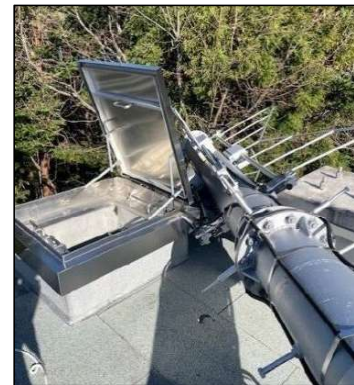
送信アンテナの損壊
