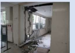
学校施設の被害
