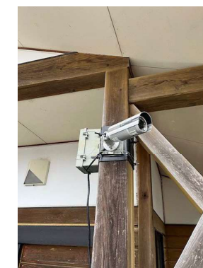
防犯カメラの設置
