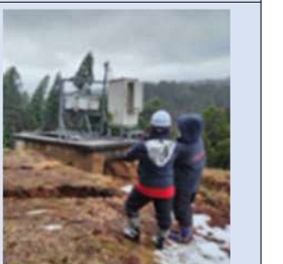
通信基地局の損壊
