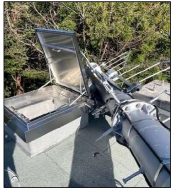
送信アンテナの損壊
