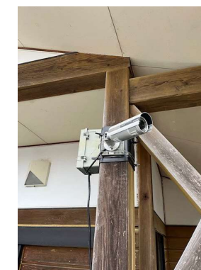
防犯カメラの設置
