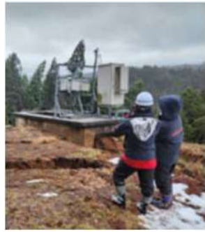
基地局の損壊
