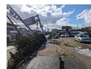
液状化被害（内灘市街地）
