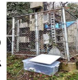
可搬型衛星アンテナ
