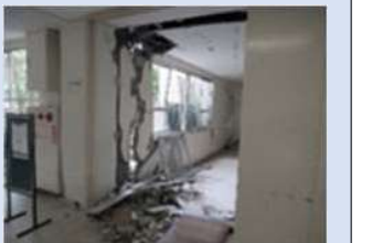
学校施設の被害
