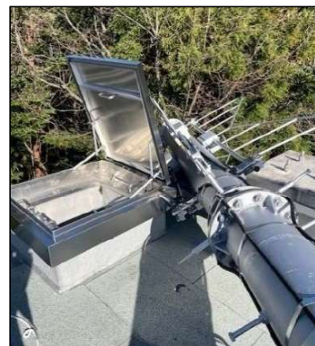
送信アンテナの損壊
