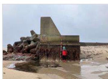
鹿磯（かいそ）漁港の地盤隆起
