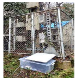
可搬型衛星アンテナ
