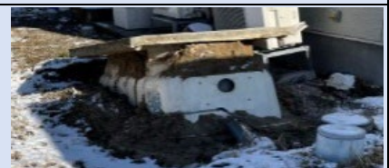
地震により浮き上がった 浄化槽(七尾市内の例)
