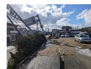
液状化被害（内灘市街地）
