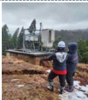
基地局の損壊
