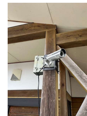
防犯カメラの設置
