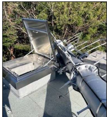
送信アンテナの損壊
