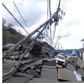
地震による被害
