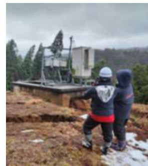
基地局の損壊
