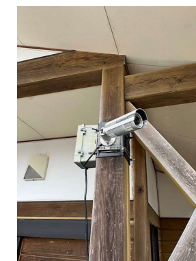
防犯カメラの設置
