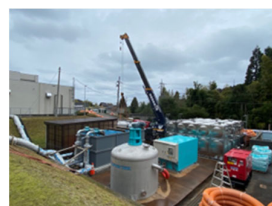
▲浄水場での活用(珠州市) 施設Ⅱ
