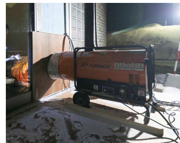
▲ダクトヒーターの使用状況（屋外設置）
