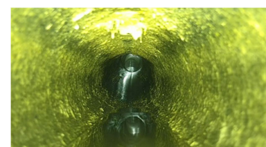
▲カメラ映像（管路折れ曲がり）
