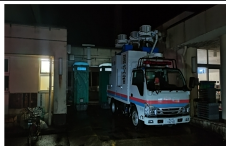
▲ 電源供給により停電を解消
