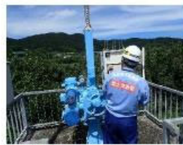
施設毎に機側操作盤により操作
