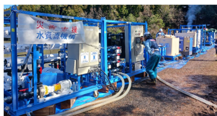
▲可搬式浄水施設（施設Ⅰ）の全景
