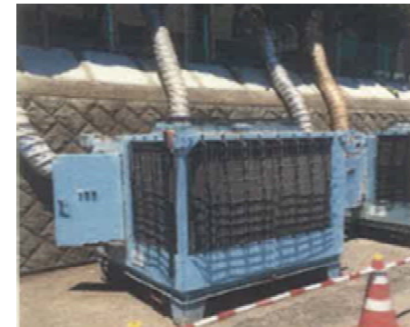
エアコン(室外機)
