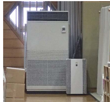
エアコン(室内機)
