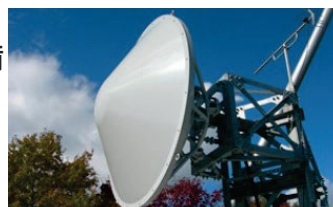
地上系通信設備（多重無線設備） 通信衛星
