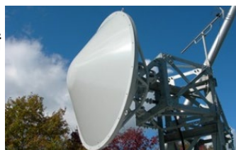
地上系通信設備 (多重無線設備)
