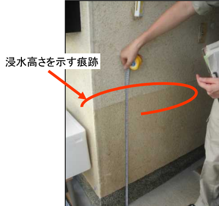
＜浸水が床上を越えている例＞
