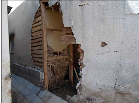
＜外力被害がある例(瓦礫の衝突)＞
