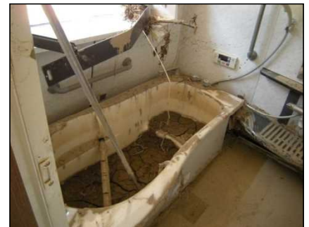
（泥流により使用できなかった浴室） 5303
