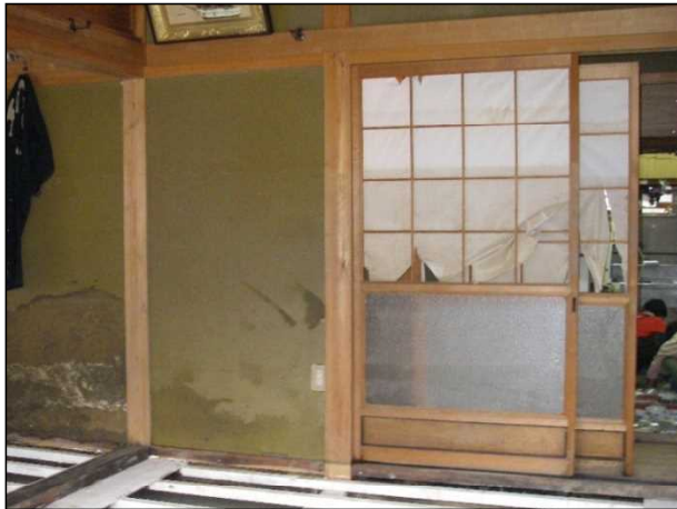
【障子・襖】 浸水による襖・障子・ドアの破損(表面、格子・縁の洗浄、張り替えによって、再使用が可能な程度)
