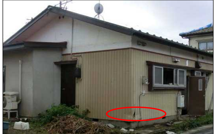
＜外力被害がある例(瓦礫の衝突)＞
