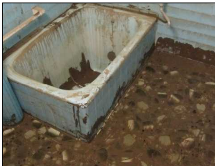
（浴槽：汚損し、配管が詰まっている。） 5301
