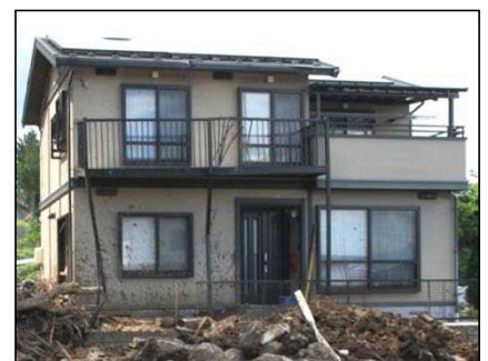
（ベランダ：外力等により変形している。） 5309
