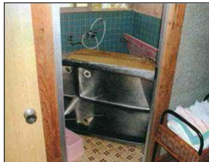
（浴槽：転倒し、配管が切れている。） 5302
