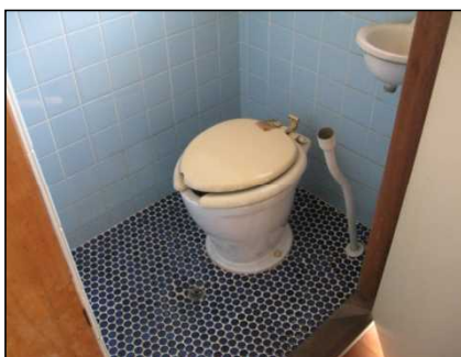
（便器：配管が外れている。） 5307
