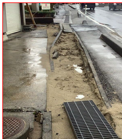
液状化による外構の被害が見られる。 40000
