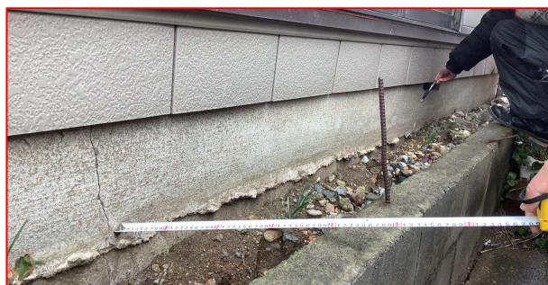
液状化による基礎や外構と地盤面とのズレが見られる。 40000
