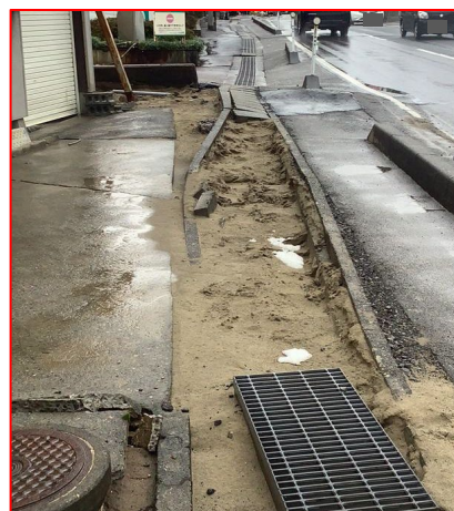
液状化による外構の被害が見られる。40000
