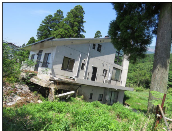
斜面崩壊により建物全体に傾斜が見られる。 40002
