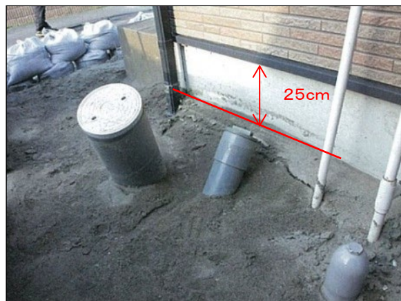
基礎の天端下25cmまで潜り込んでいる。
