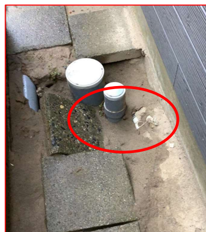
液状化による配管の露出が見られる。 40000
