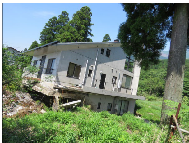
斜面崩壊により建物全体に傾斜が見られる。 40002
