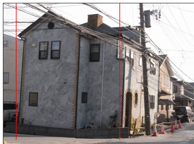
不同沈下による基礎・床も含めた傾斜が見られる。 40001
