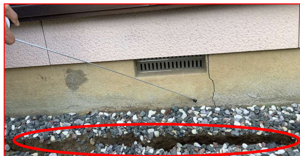
液状化による地面の亀裂が見られる。 40000
