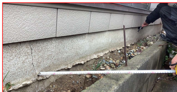
液状化による基礎や外構と地盤面とのズレが見られる。 40000
