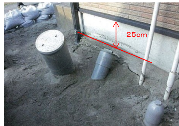
基礎の天端下25cmまで潜り込んでいる。
