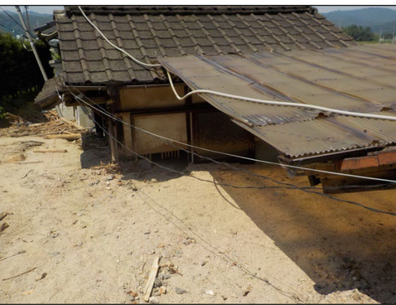
土砂等が住家及びその周辺に一樣に堆積している。
