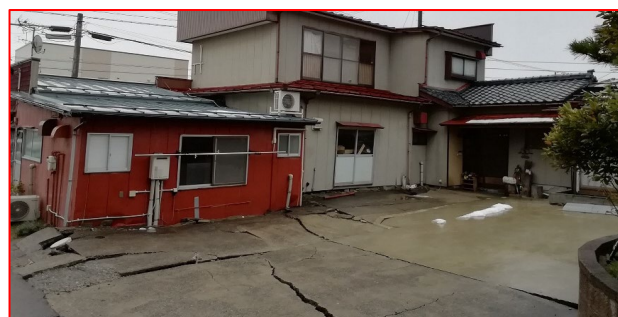
液状化によるコンクリート地盤の割れが見られる。 40000
