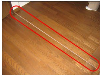
床板の継目に隙間が生じている。
