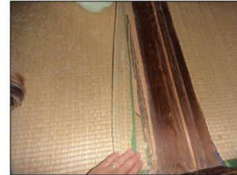
床仕上・壁に損傷が見られる。
