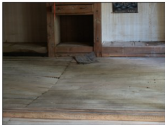
床板に著しい不陸、折損が見られる。
