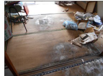
床仕上・壁に著しい損傷が見られる。
