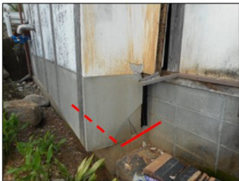
土台が基礎から著しくずれている。
