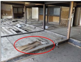
床板に著しい不陸、折損が見られる。
