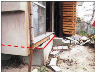
土台が基礎から著しくずれている。
