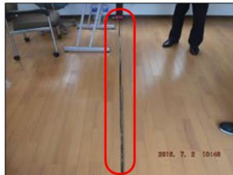
床板の継目に隙間が生じている。
