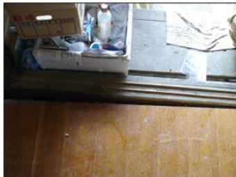
床板にずれ、若干の不陸が見られる。
