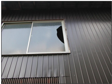
損傷程度Ⅲ(50%)の例
