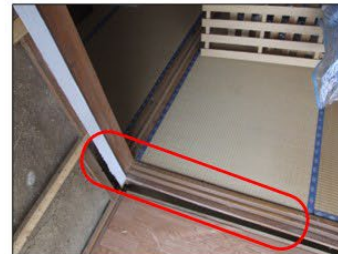
床板にずれ、若干の不陸が見られる。
