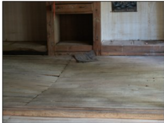
床板に著しい不陸、折損が見られる。
