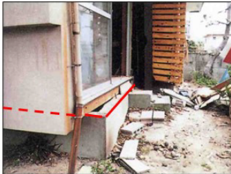
土台が基礎から著しくずれている。
