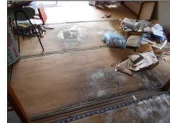
床仕上・壁に著しい損傷が見られる。
