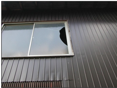
損傷程度Ⅲ(50%)の例
