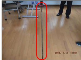
床板の継目に隙間が生じている。
