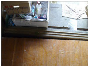
床板にずれ、若干の不陸が見られる。
