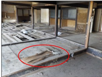
床板に著しい不陸、折損が見られる。
