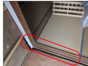
床板にずれ、若干の不陸が見られる。
