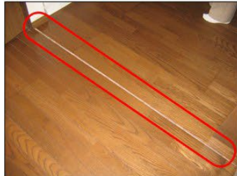
床板の継目に隙間が生じている。
