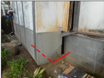
土台が基礎から著しくずれている。
