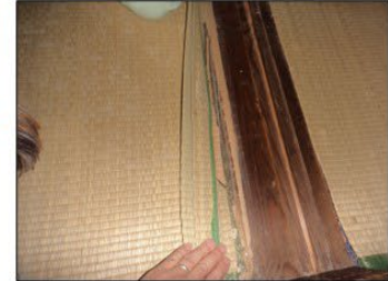
床仕上・壁に損傷が見られる。
