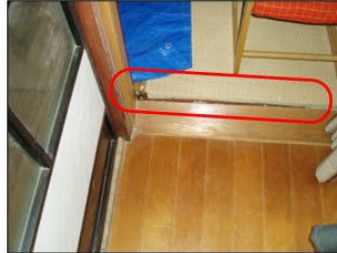
(床と壁との間にわずかなずれが生じている。)
