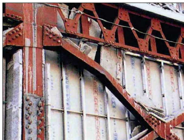
【鉄骨造】 座屈変形が見られる。
