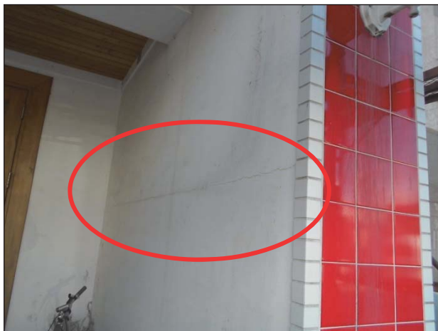
【外部仕上】 仕上げや仕上材の目地にわずかなひび割れ(幅約0.2mm)が見られる。
