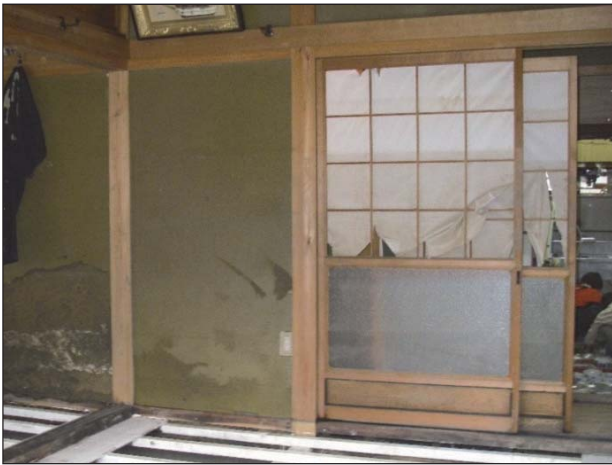
20094 【障子・襖】 浸水による襖・障子・ドアの破損(表面、格子・縁の洗浄、張り替えによって、再使用が可能な程度)
