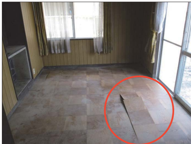
浸水によりフローリング材の層間剥離・浮き上がり、沈下が見られる。
