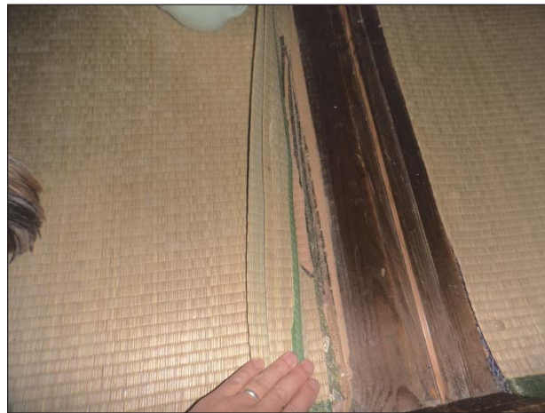
床仕上・畳に損傷が見られる。
