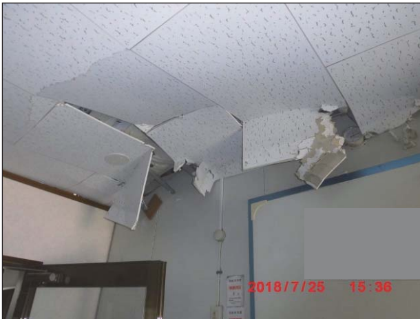
天井板が脱落している。
