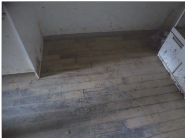
浸水により床板の汚損が見られる。
