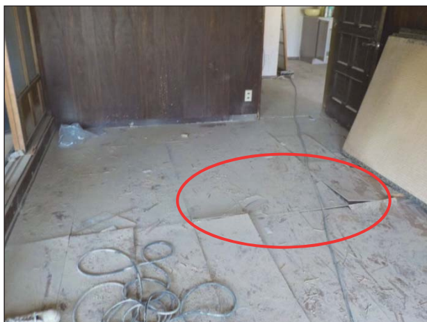
浸水により床板に著しい浮き、ずれ、剥離が見られる。
