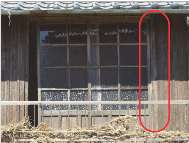
10147 【木製サッシ】 壁面との間に隙間が生じている。
