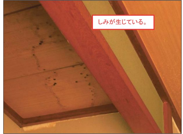
浸水による天井仕上(クロス等)の剥離・表面劣化が見られる。 (下地材の交換を要しない程度)
