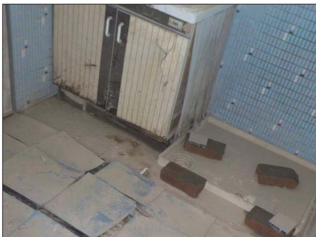
浸水により合成樹脂系床材の剥離が見られる。
