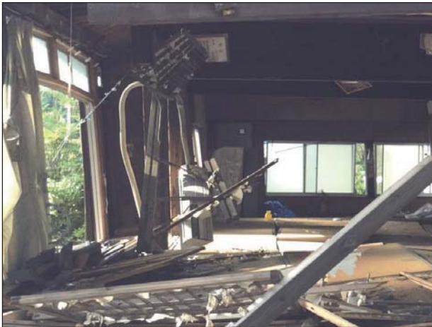
10105 全ての床板に著しい不陸が見られる。
