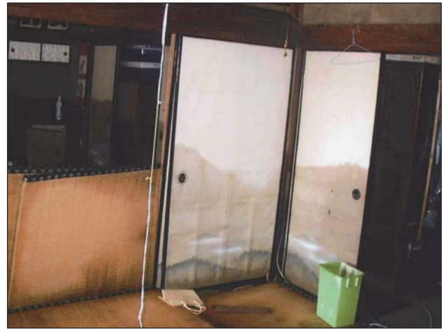
20095 【障子・襖】 浸水による襖・障子・ドアの破損(表面、格子・縁の洗浄、張り替えによって、再使用が可能な程度)
