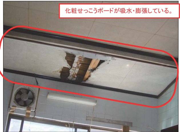
浸水による下地材・化粧せっこうボード・その他天井材の吸水・膨張・不陸等の機能損失が見られる。 (下地材・天井板の交換を要する程度)
