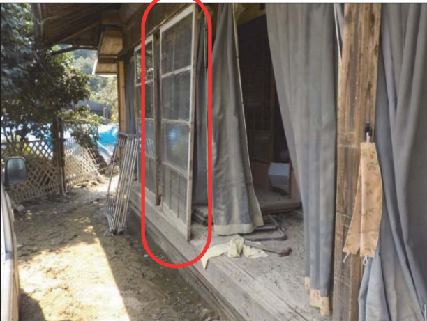
20096 【木製サッシ】 破損し、開閉が困難になっている。
