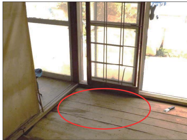
浸水により床板に若干の浮き、ずれが生じている。
