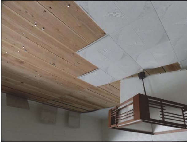
浸水による天井仕上(クロス等)の剥離・表面劣化が見られる。 (下地材の交換を要しない程度)
