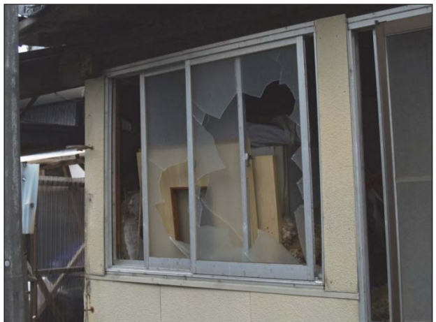
20097 【アルミサッシ】 ガラスが破損している。
