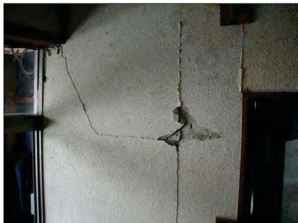
【内部仕上】 クロスが破れている。 9505
