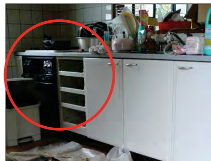
(システムキッチンのコンロ類が浸水により故障して使用不可能になっている。)
