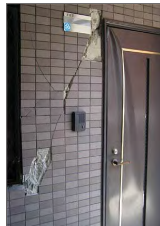
【雑壁】 9306 全体にひび割れ(幅約0.2mm～1mm)やはがれが生じている。
