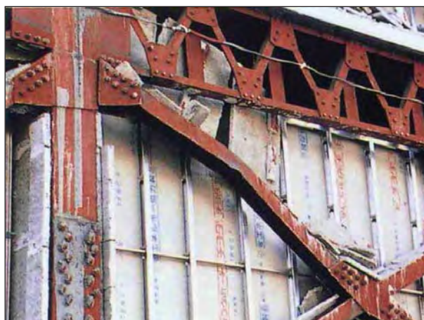
【鉄骨造】 座屈変形が見られる。
