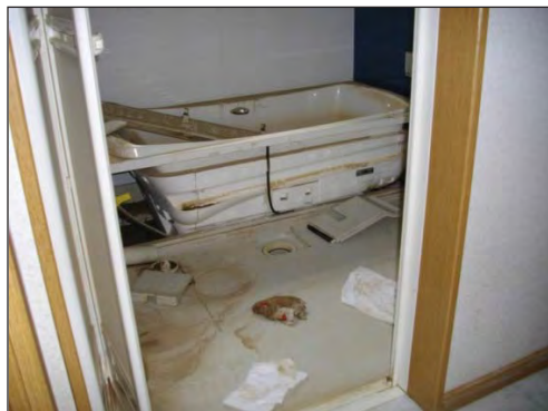
(浴槽：破損している。)
