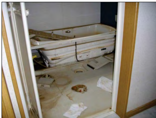
(浴槽：破損している。)
