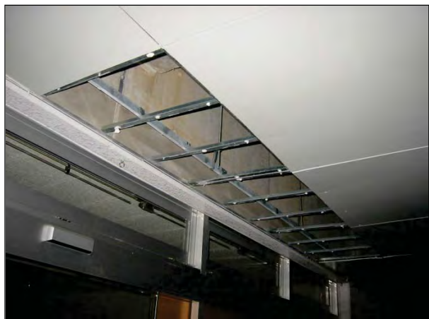
【天井】 9604 天井板が脱落している。
