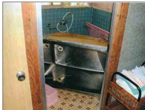
(浴槽：転倒し、配管が切れている。)
