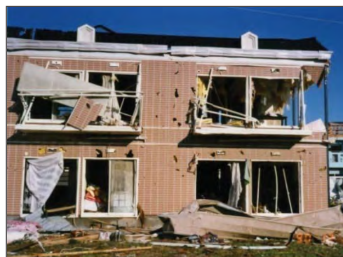
(ベランダ：手摺が破損している。)
