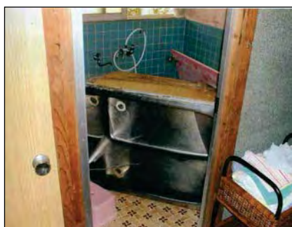
(浴槽：転倒し、配管が切れている。)
