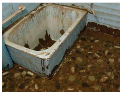
(浴槽：汚損し、配管が詰まっている。)
