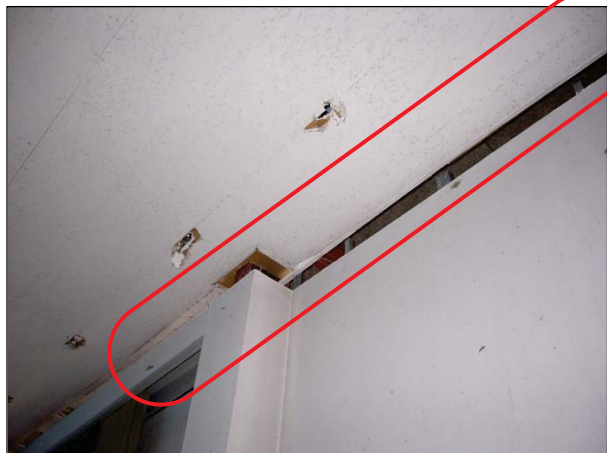
【天井】 9602 天井板のずれが見られる。
