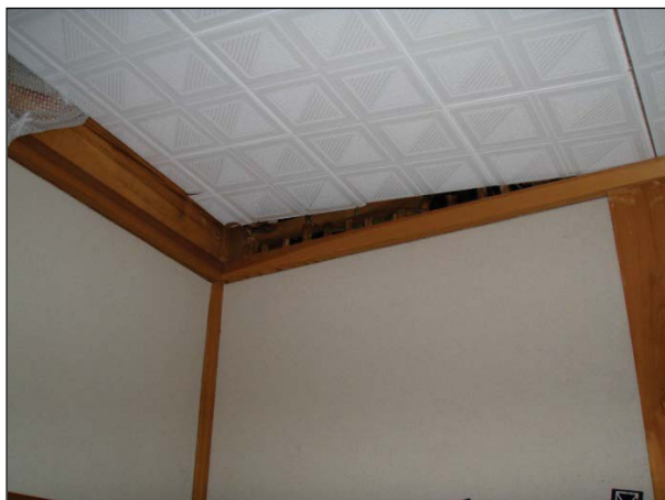
【天井】 天井板の浮きが生じている。 9506
