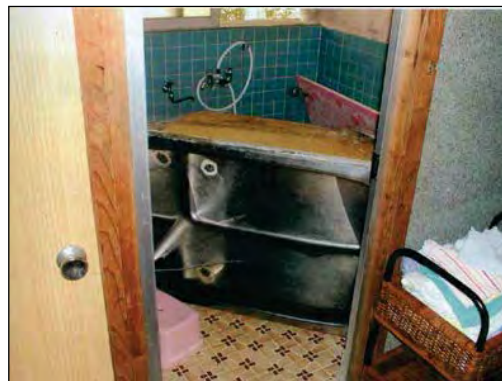
(浴槽：転倒し、配管が切れている。)
