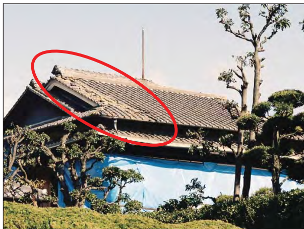
1506 棟瓦以外の瓦もずれが著しい。
