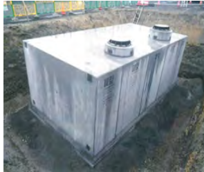
耐震性貯水槽
