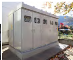
電気設備高上げ
