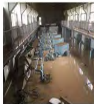
浸水被害を受けたポンプ施設
