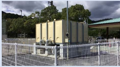
受水槽設置の例
