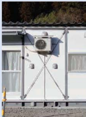
エアコン室外機の高所設置、 ・鋼製基礎設置の例
