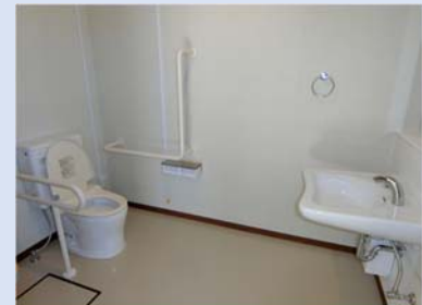
車いす対応トイレ
