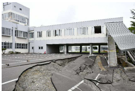
福祉施設（本郷地区）の被害状況
