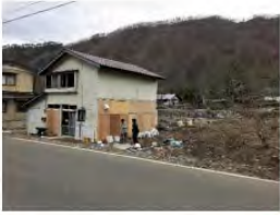
修繕費が足らず、トイレがなくなったままの住宅
