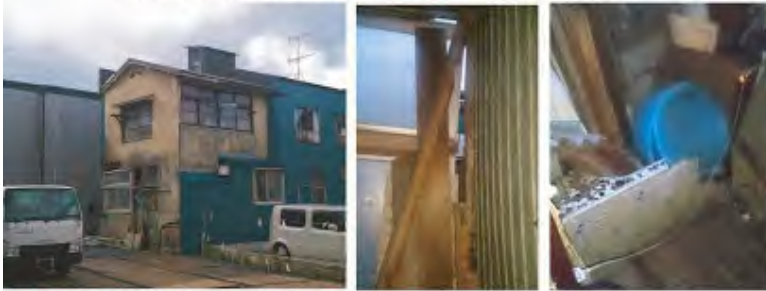
石巻市市街地地区／老人世帯（姉妹）／壁から外が見え、風呂は壊れたまま。金銭的な理由でこれ以上の修繕はあきらめている。
