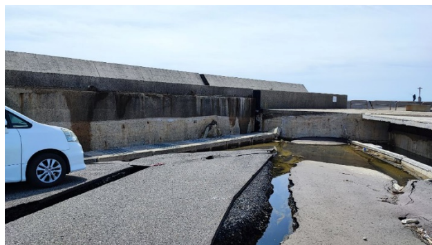
液状化による港湾施設の沈下
