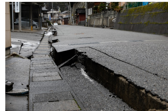
液状化による宅地の沈下
