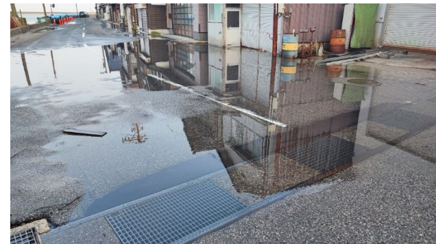
地盤沈下により冠水被害が発生 (宇出津港)
