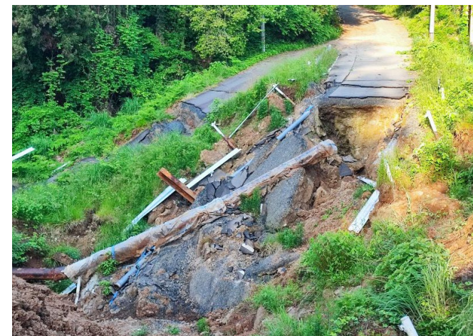
町道崩壊により破損した水道本管
