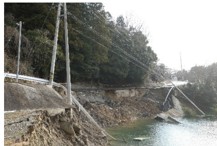
海沿いの道路崩壊
