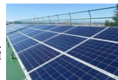
太陽光パネル
