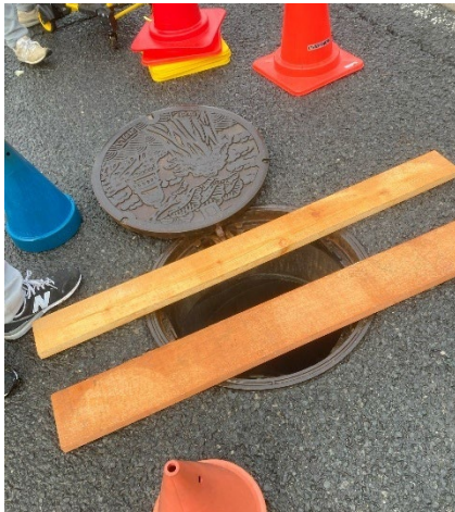
マンホールトイレ
