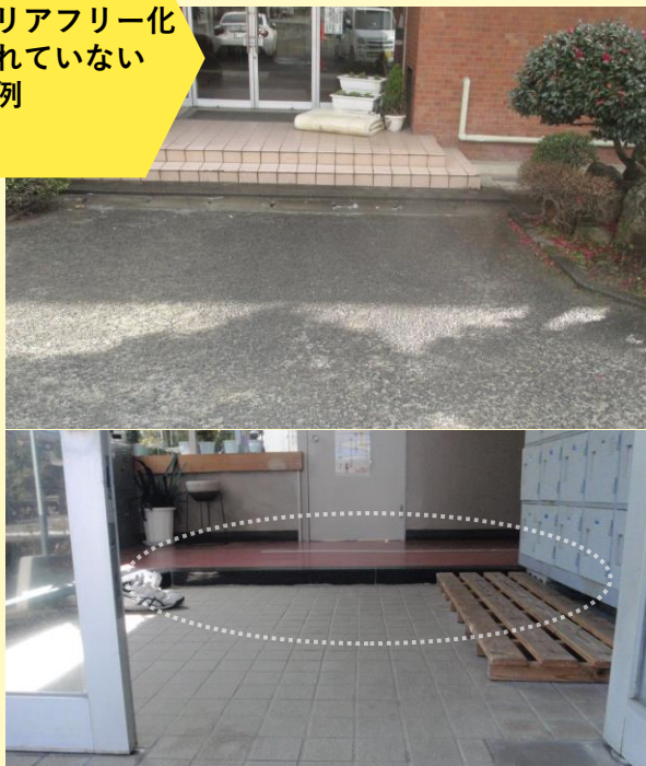
①昇降口など に段差が あった
