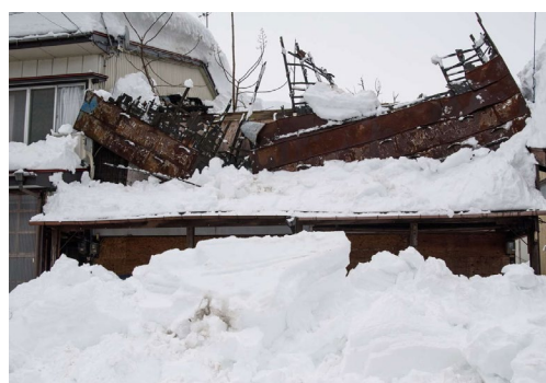
令和3年1月の空き家の倒壊状況（新潟県上越市）
