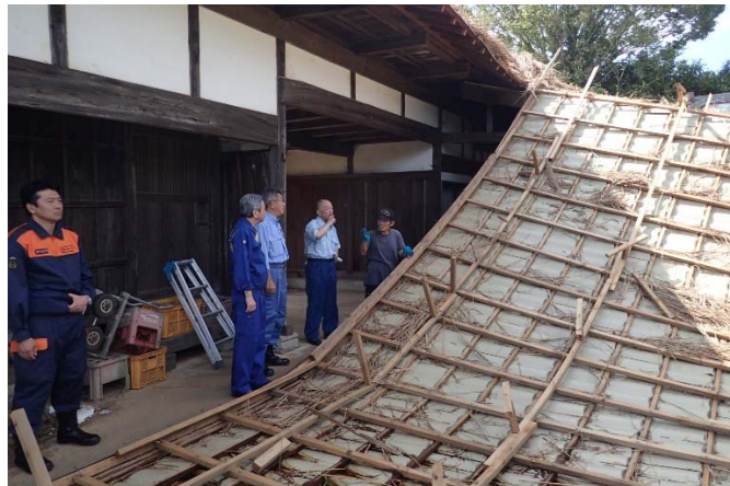
香取市栗源地区被災民家 【千葉県香取市】
