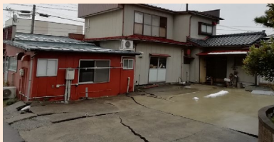
コンクリート地盤の割れ
