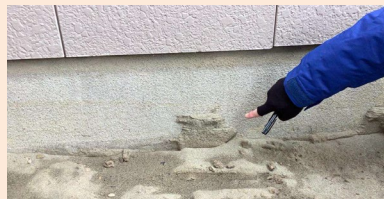
地盤から噴砂した形跡
