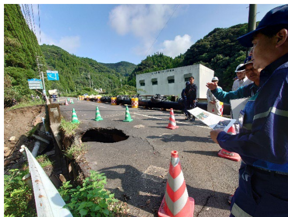
水道管橋損傷現場視察 【鹿児島県霧島市】
