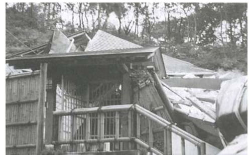
土砂崩れにより全壊した店舗兼住宅 （小田倉地区）（福島県災害の記録）
