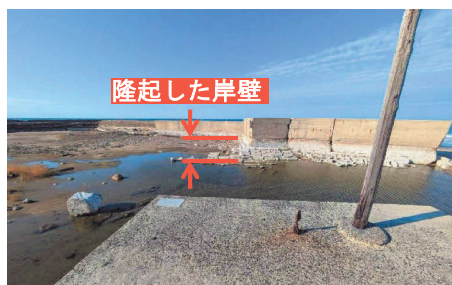
黒島地区の海岸も隆起により船着き場の岸壁が2m以上もせり上がっている
