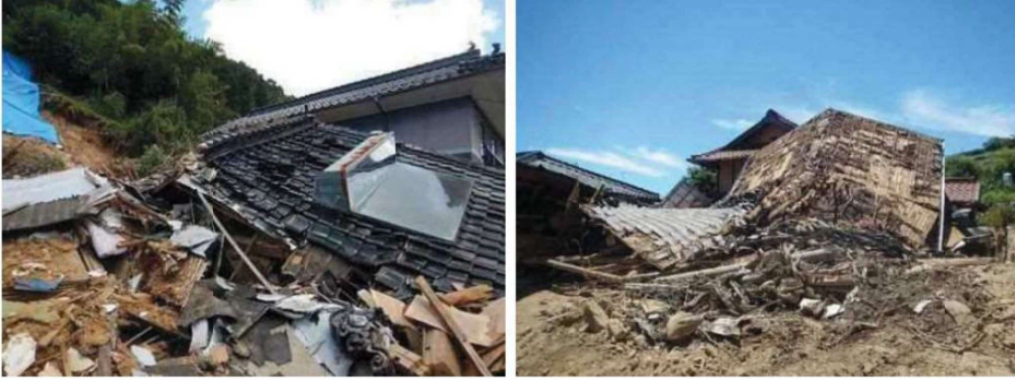
家屋の被災状況(左:府中市木野山町/右:三原市木原6丁目)
