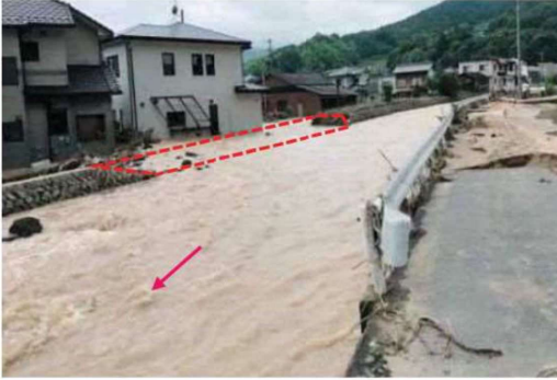
河川の破堤状況(野呂川水系中畑川)
