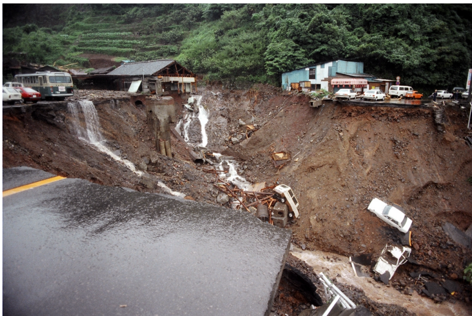
国道 34 号芒塚の道路流失 提供：DEITz(株)（本書 137 頁）
