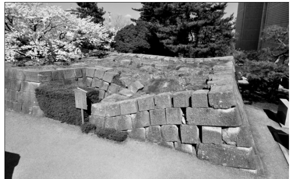
写真コラム2-1 福井地震によってたわんだ天守の石垣（2010年4月8日撮影）
